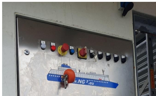
Manuell betjening fra elektrisk skap
