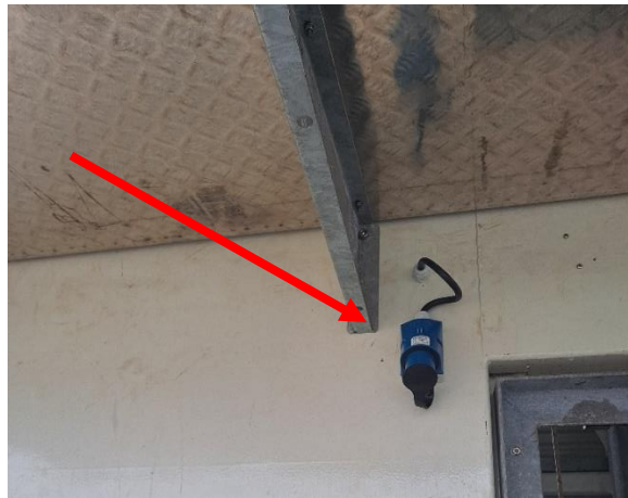
Stikkontakt for tilkobling av aggregat
