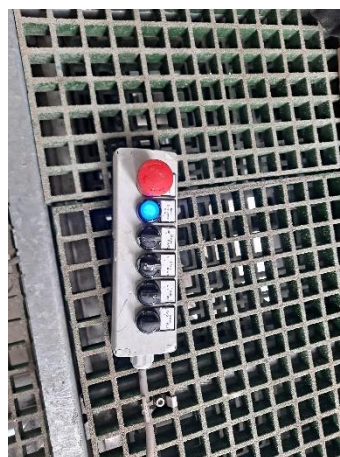
C&C-bærbart betjeningspanel på plattformen
